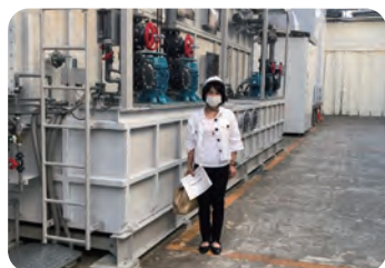
バイオマスエコセンターの見学 長年の要望・生ごみの堆肥化と、学校での農業体験・農業での堆肥活用が実現に
